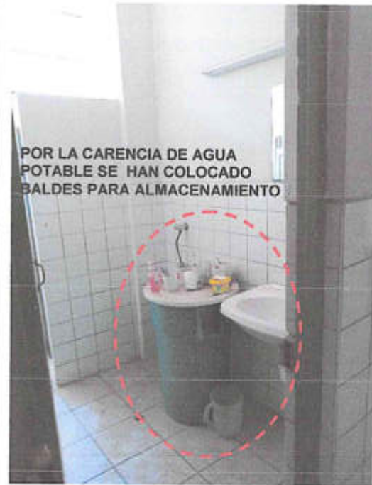
SS.HH INOPERATIVOS GRIFERIAS EN MAL ESTADO
