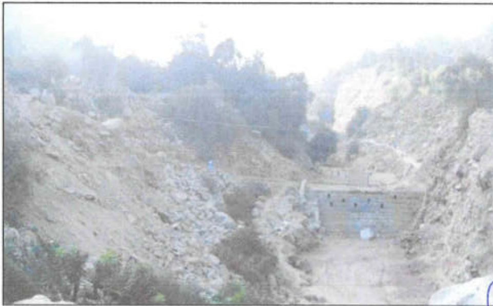
Figura 20: Quebrada Pedregal. Muros de contención y depósitos de flujos de detritos en ambas laderas de la quebrada.
